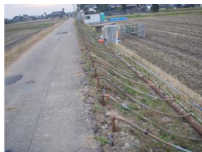
ウエルポイント工法により掘削前に地下水水位を低下させている状況
