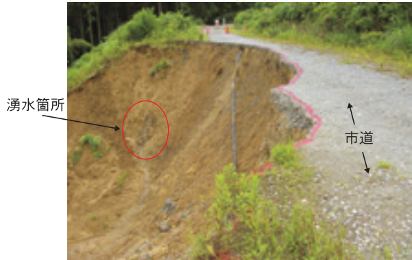
被災状況(旧地山と盛土境界で崩落し、市道が欠損)
